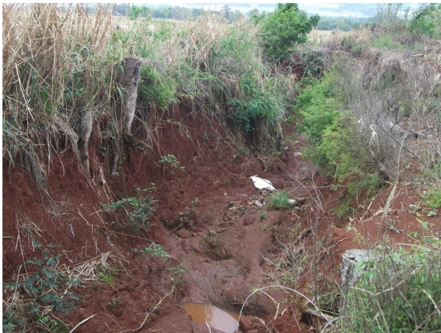
Figura 10: Voçoroca provocada pelo escoamento de águas do centro urbano em direção ao interior do município. Julho de 2011.
