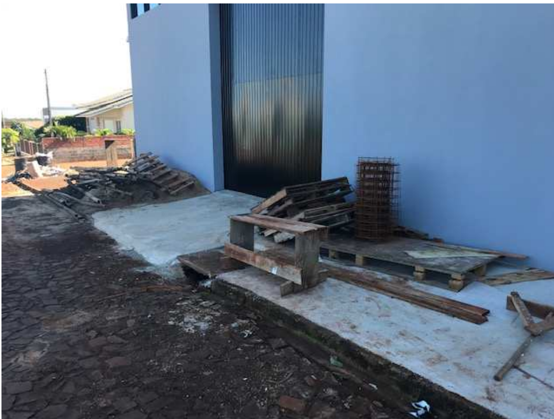
Imagem 04: RCC que podem ser reutilizados dispostos em local inadequado.
