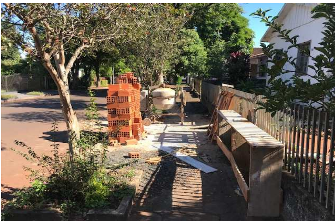
Imagem 02: Materiais dispostos em local inadequado (calçada), interferindo no tráfego de pedestres.
